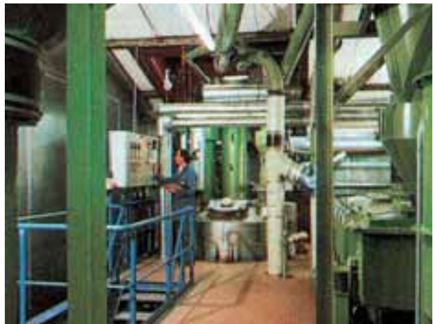
Anlage zur Aufbereitung von Ausbaumasphalt
